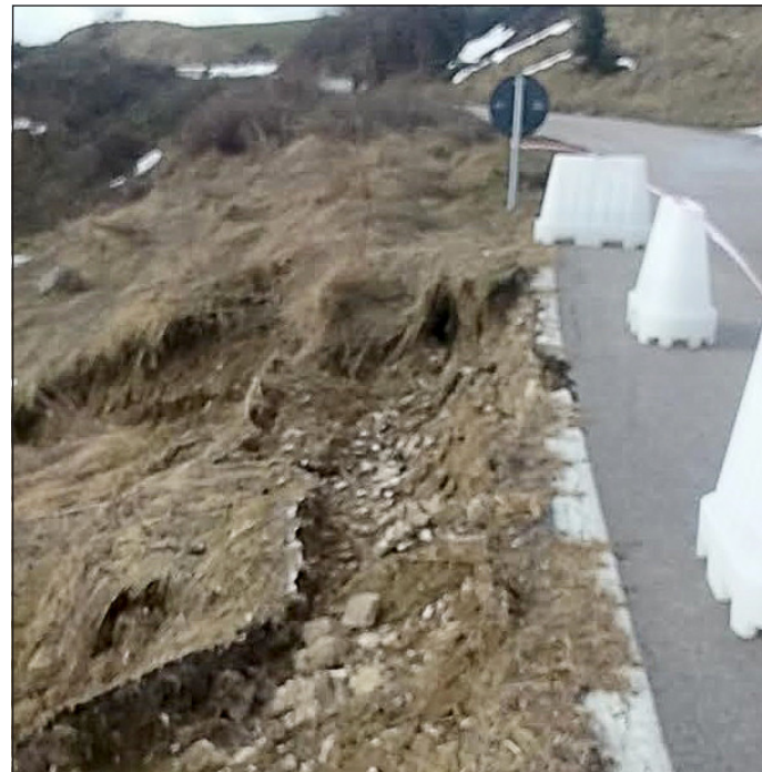
La frana che sta interessando un tratto di strada tra Mirabello e Vinchiatturo
